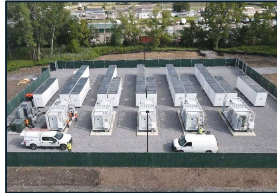
45.6 MWh BESS - Buffalo, NY
