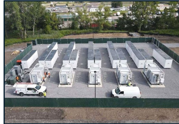
45.6 MWh BESS - Buffalo, NY
