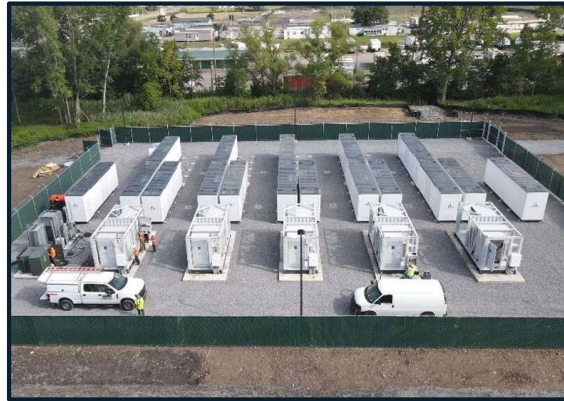
45.6 MWh BESS - Buffalo, NY
